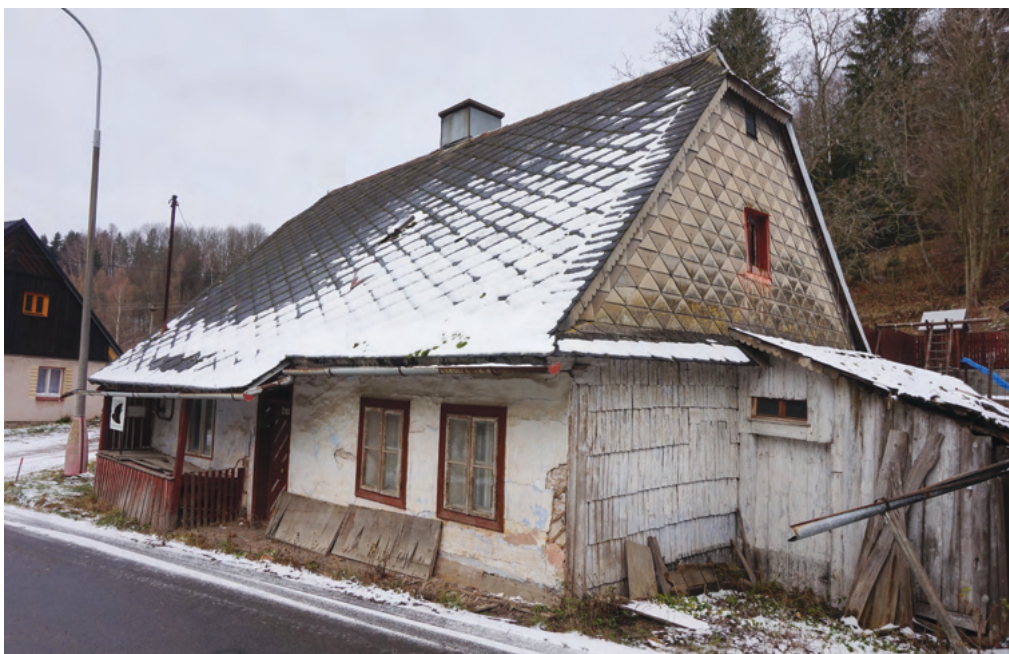
13. Chalupa čp. 153 je zaznamenána až v roce 1839 v majetku domkáře Franze Weinlicha. Objekt byl upravován v průběhu let 1839–1874, kdy zřejmě získal nynější mladší podobu sedlové střechy bez výrazných námětků typických pro starší období. Zadní roubená stěna je pokrytá bílým šindelem.
