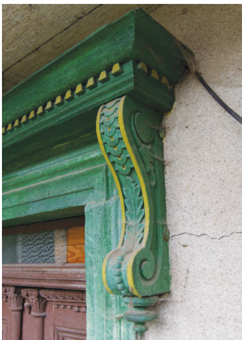
5-11 Propojení kamenného portálu s dřevěnou dekorativně bohatou konzolou a řezbářsky náročně zpracovanými domovními dveřmi na domě usedlosti čp. 60 v Moravském Karlově, v poměrně nepřístupné horské poloze, je zřejmě kompromisem mezi požadavkem reprezentativnosti a materiálovou dostupností. Nedatovaný prvek reprezentuje patrně až závěr 19. století.
