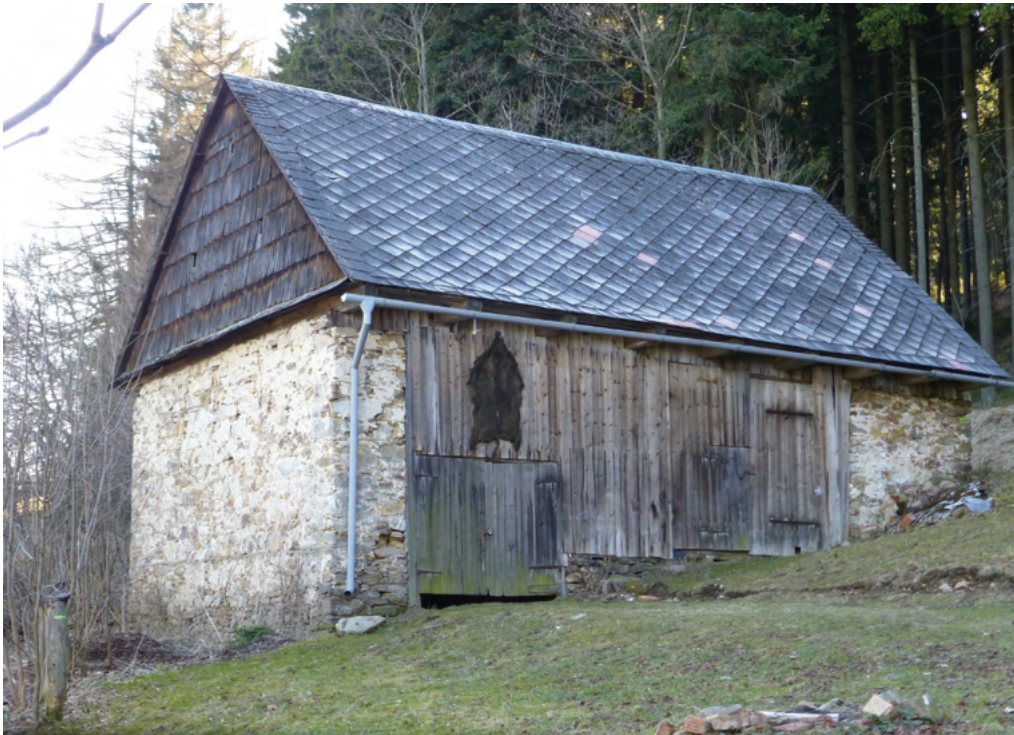
3-43 Horní Morava čp. 1. Pohled na obdélnou kamennou stodolu s bedněnou výplní stěn, postavenou po roce 1856. Stavba má sedlovou střechu a šindelem pobitou konstrukci štítu. Umístění kolmo do svahu umožňuje snadný příjezd po vrstevnicové cestě.
