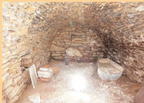
3-8 Příklad všeobecně rozšířeného kamenného sklípku s neomítanou valenou klenbou z místního lomového kamene, s odkládacími či osvětlovacími výklenky v čelní i postranní stěně.
