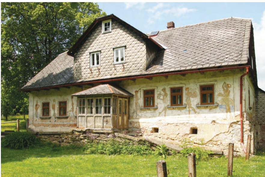
14. Domkářský objekt čp. 27 na okraji panského lesa v Horních Boříkovicích byl první nespalnou (alespoň částečně zděnou) stavbu této lokality. Vysoká podezdívka reaguje na blízkost potoka, křížová podkrovní světnička rozšiřuje obytné využití. K roku 1900 zde žila čtyřčlenná rodina dřevorubce Lichtensteinského polesí Johanna Doleschela se dvěma ponájemníky (námezdními tkalci) a v druhé domácnosti pětičlenná rodina Ziegnerů, také námezdních tkalců.
