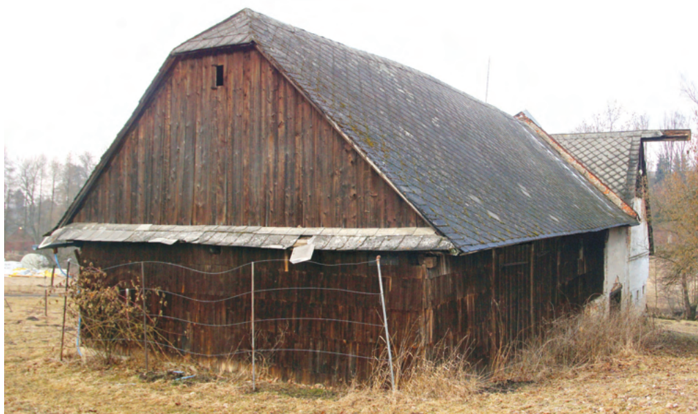
9. Menší usedlost čp. 40, s dřevěným domem a stodolou, vlastnil k roku 1839 Franz Langer, jehož jmenovec, patrně syn, narozený v roce 1830, se uvádí jako majitel i k roku 1890. V mezidobí, zřejmě až v 70./80. letech 19. století, byl dům přestavěn do zděné podoby a propojený přístavbou stodoly do hákové dispozice. (SL)
